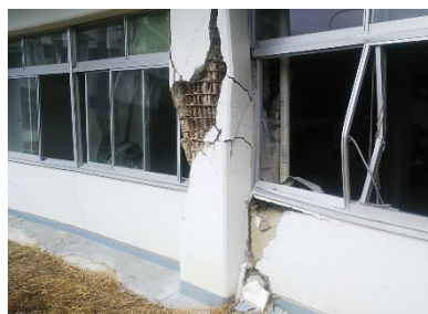
柱が折れて見えている内部の鉄筋
